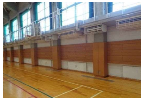
第1体育館エアコン
